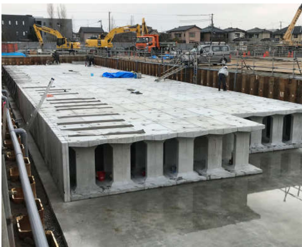
洪水対策の雨水地下貯水槽
